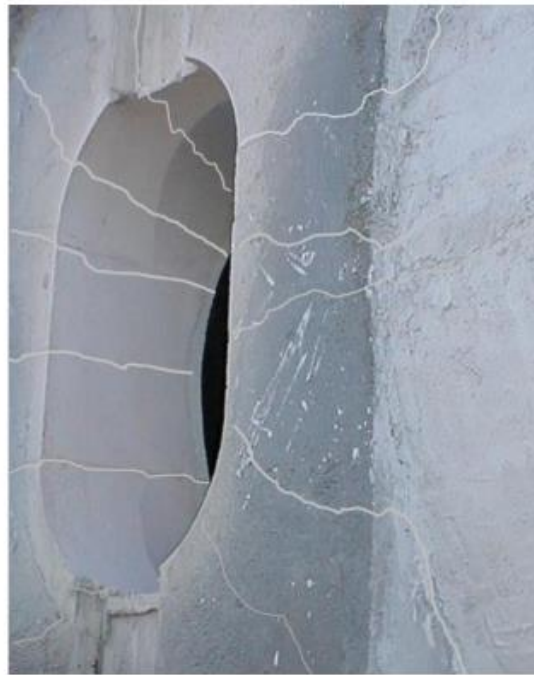
Rissbildung Trotz Abstell-/Konstruktionsfugen
